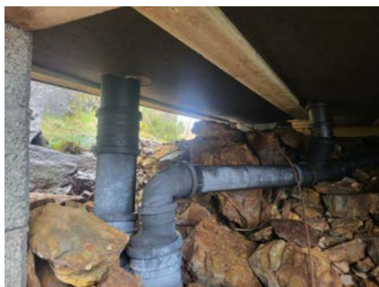
Utvendige avløpsrør under hytta.
