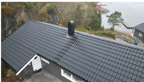
Manglende snøfangere på taket.
