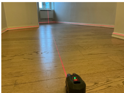
Nivellering soverom, avvik ca. 10-20 mm
