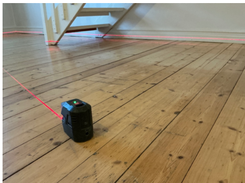
Nivellering stue, avvik ca. 15-30 mm
