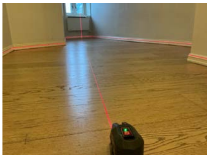
Nivellering soverom, avvik ca. 10-20 mm
