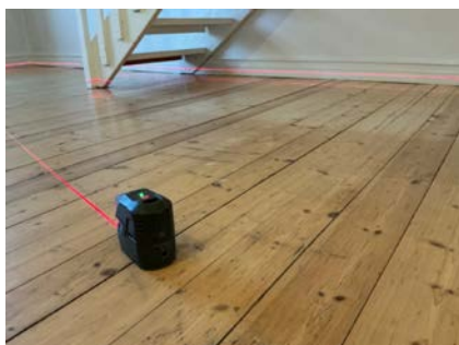
Nivellering stue, avvik ca. 15-30 mm
