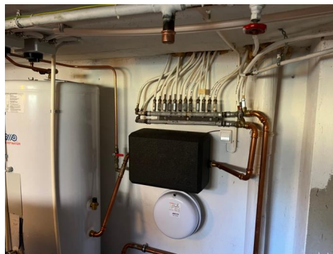
Varmeanlegg i kjeller.
