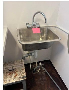
Utslagsvask har våtzone på vegg som bør utbedres.
