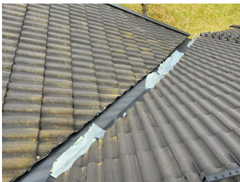
Avflasset lakk i gradrenne.
