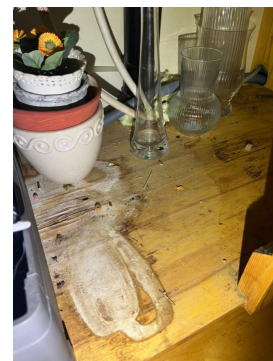
Bunnplate i benkeskap har skader.
