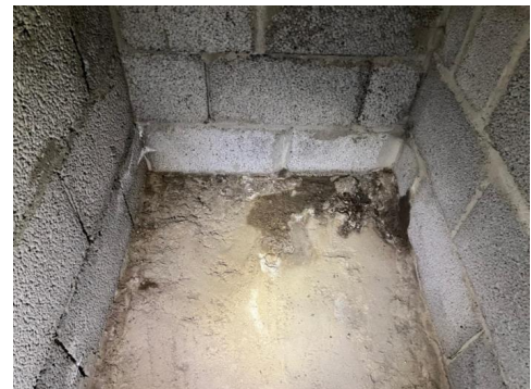
Noen fuktmerker innerst i korridor teknisk rom.
