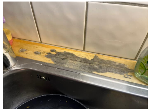
Fuktmerker på benkeplate.
