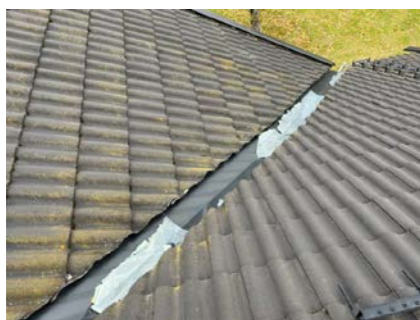
Avflasset lakk i gradrenne.
