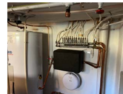
Varmeanlegg i kjeller.
