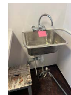
Utslagsvask har våtzone på vegg som bør utbedres.
