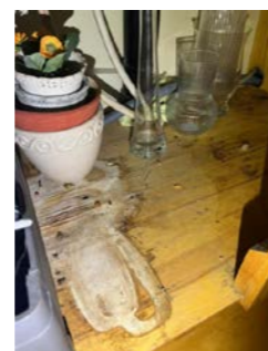
Bunnplate i benkeskap har skader.
