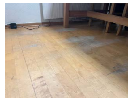
Parkett på kjøkken har slitasje.
