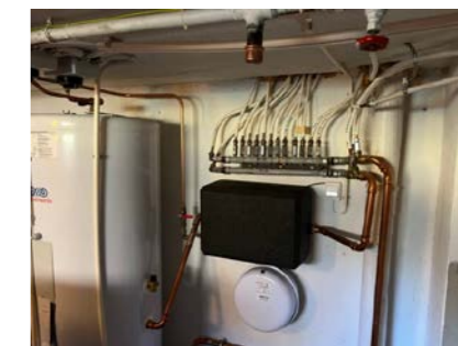
Varmeanlegg i kjeller.
