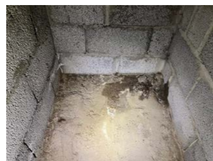
Noen fuktmerker innerst i korridor teknisk rom.
