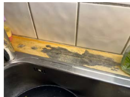
Fuktmerker på benkeplate.
