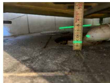
Det ble målt mindre motfall fra dør til sluk.
