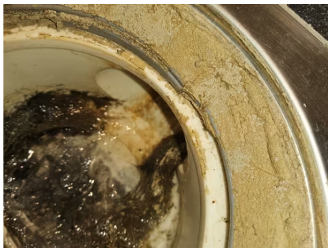
Det registreres tegn til en sprekk i slukets klemring.
