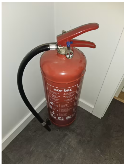
Brannslukningsapparat er plassert i entré.
