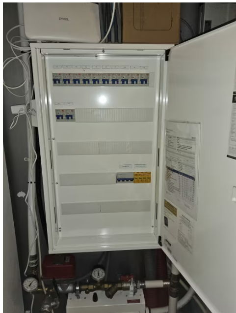
Sikringsskap er plassert i bod/teknisk rom.
