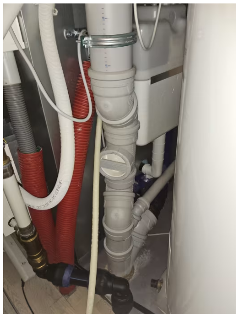
Stakeluke er plassert i teknisk rom.
