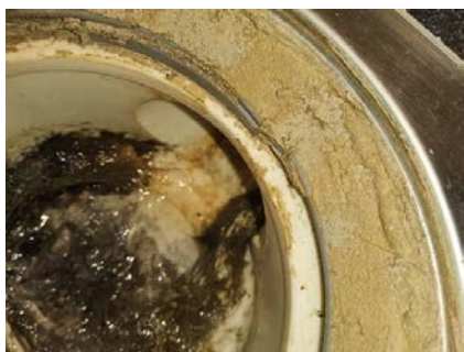
Det registreres tegn til en sprekk i slukets klemring.
