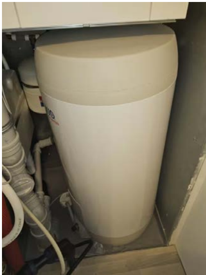
Varmtvannsbereder er plassert i bod/teknisk rom.
