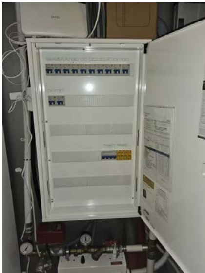
Sikringsskap er plassert i bod/teknisk rom.
