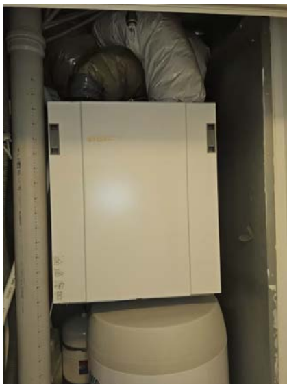
Ventilasjonsaggregat er plassert i bod/teknisk rom.
