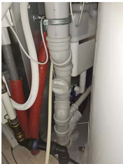
Stakeluke er plassert i teknisk rom.
