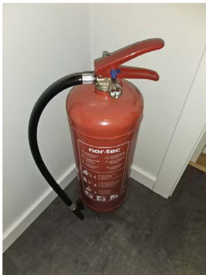
Brannslukningsapparat er plassert i entré.
