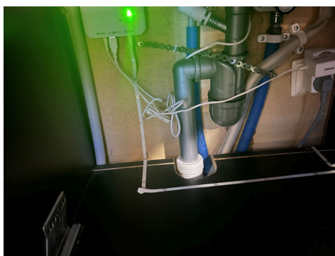
Det mangler stengemuffe mellom vannrør og varerør
