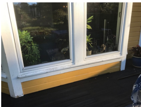
Råteskadet bordkledning under vinduer på karnapp.
