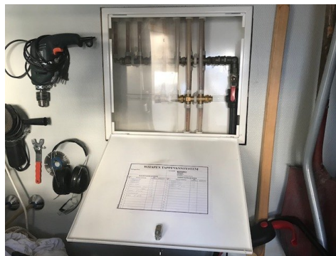
Stengekran i fordelerskap
