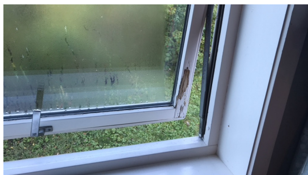
Slitasje/fuktmerker på soveromsvindu i 2. etasje.
