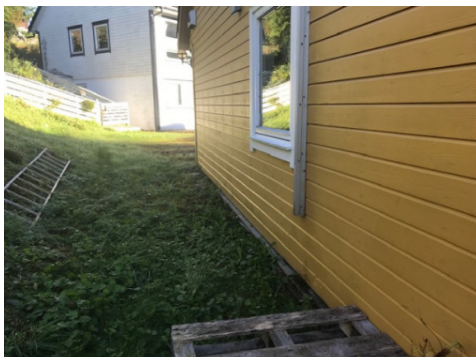
Bordkledningen ligger for tett til terreng/bakkenivå.
