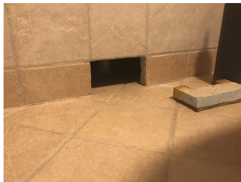
Dårlig tilkomst til sluk.
