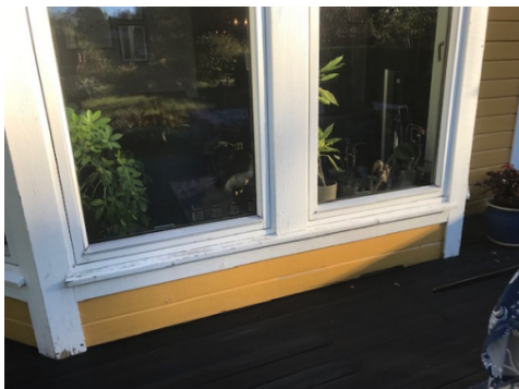
Stedvis værslitasje på utvendig belistning.
