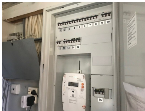
Sikringsskap med aut. sikringer.
