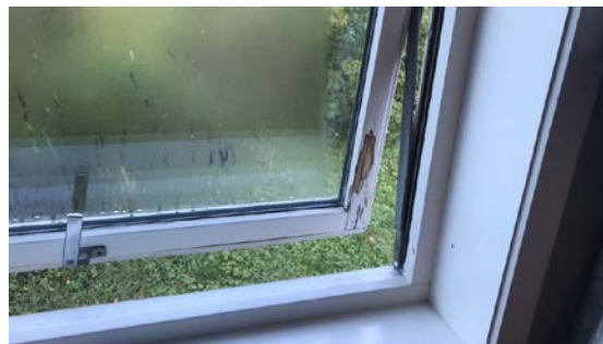
Slitasje/fuktmerker på soveromsvindu i 2. etasje.
