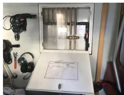
Stengekran i fordelerskap
