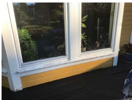
Råteskadet bordkledning under vinduer på karnapp.
