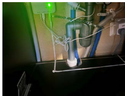
Det mangler stengemuffe mellom vannrør og varerør
