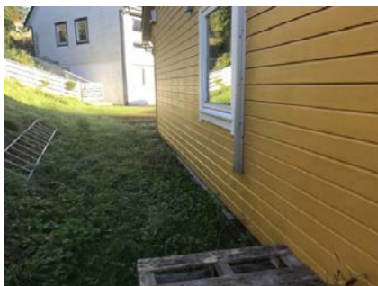
Bordkledningen ligger for tett til terreng/bakkenivå.
