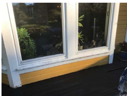
Stedvis værslitasje på utvendig belistning.
