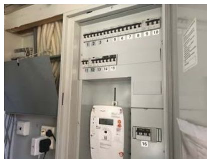
Sikringsskap med aut. sikringer.
