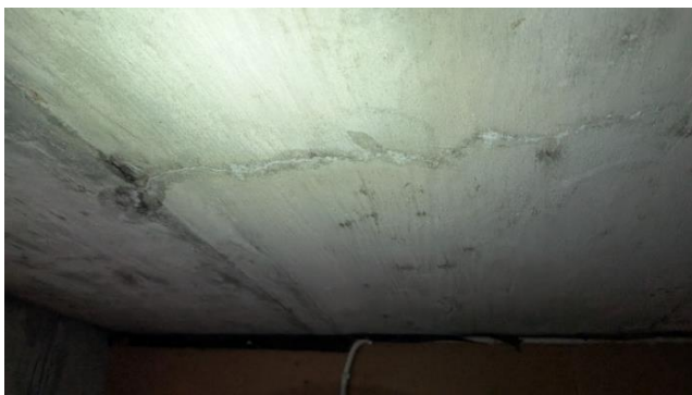
Antydning til saltutslag og sprekk/riss i dekke
