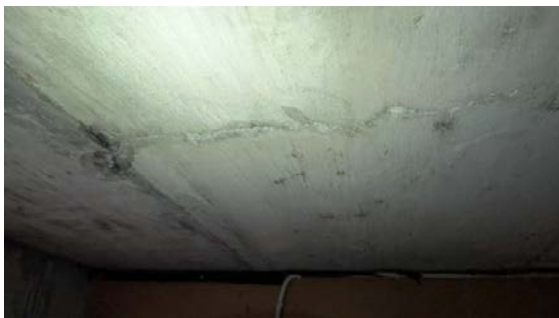
Antydning til saltutslag og sprekk/riss i dekke
