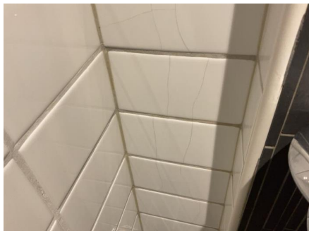
Krakelering av veggfliser.
