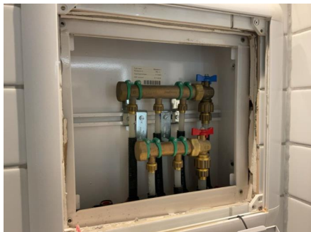
Fordelerskap med stoppekraner.
