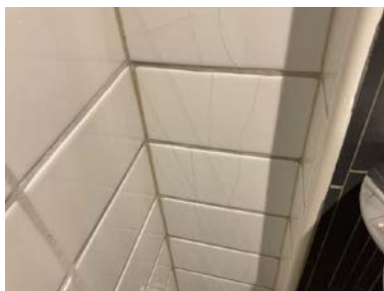
Krakelering av veggfliser.
