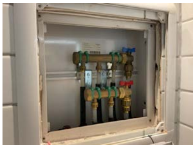
Fordelerskap med stoppekraner.
