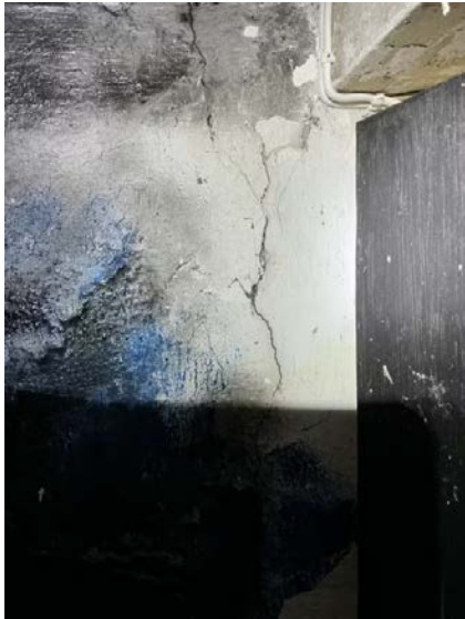
Sprekker på pussede flater på pipe i kjeller.
