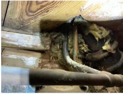
Korrosjon på eldre vannrør.
