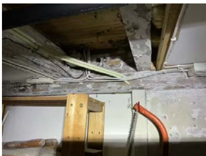
Løse ledninger i kjeller.
