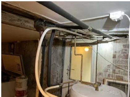
Stor avstand mellom klammer på vannrør.
