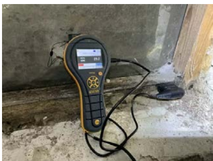
Fukt/råte på vindu i kjeller TG 3. Bytte av dårlige vindu må påregnes.
