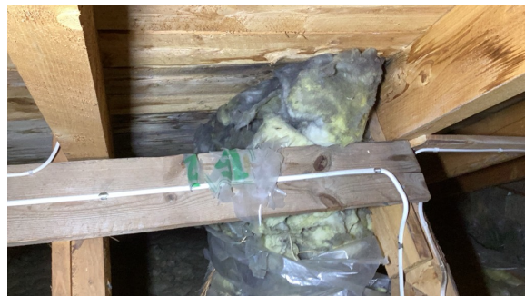
tørre fuktskjolder ved lufferør.
