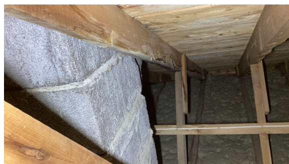
Tørre fuktskjolder ved pipe.
