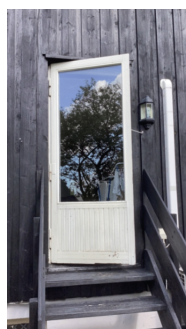
balkongdør med fuktskader, elde og slitasje.
