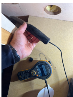
Måles ingen fukt i gulv bak dusjkabinett.
