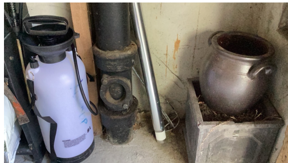
Stakeluke på avløpsrør i garasje.
