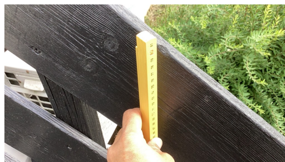
Rekkverk under 90cm.
