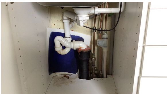
Skjolder på avløpsrør.
