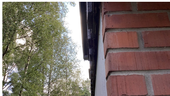
Ingen lufting bak kledning.
