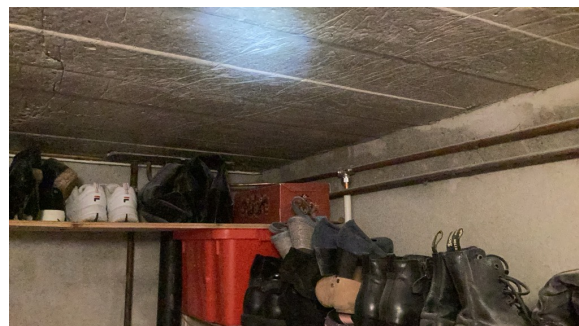
Synlige kopperrør i kjeller.
