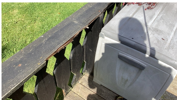
Råteskader i rekkverk.
