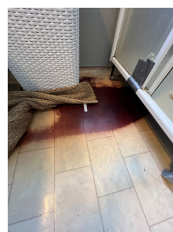
Misfarging i belegg på grunn av vanninntrengning mellom sluk og belegg, samt gulvvarme.
