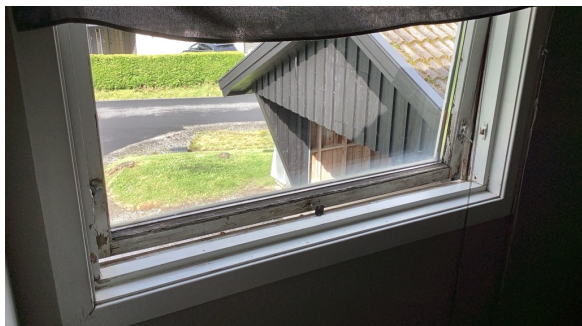
Avskaling og kondensskader på soverom.
