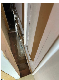
Kasse med vann og avløpsrør til bad
