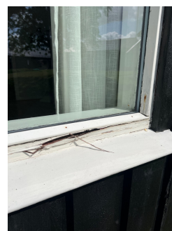
Råte i vindusramme ved spisestue.
