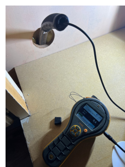
Måles ingen fukt i vegg mot dusjkabinett.
