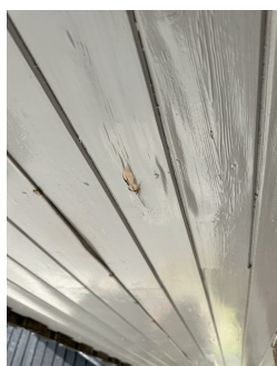
Trepanel utvendig under bad er fuktskadet.
