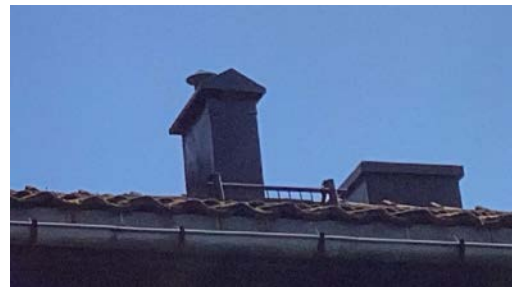
Nyere takhatt på lufferør.
