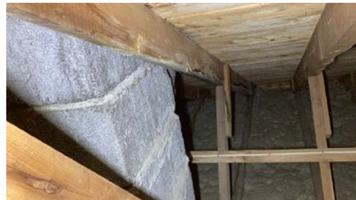
Tørre fuktskjolder ved pipe.
