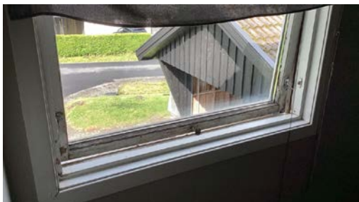
Avskaling og kondenssskader på soverom.
