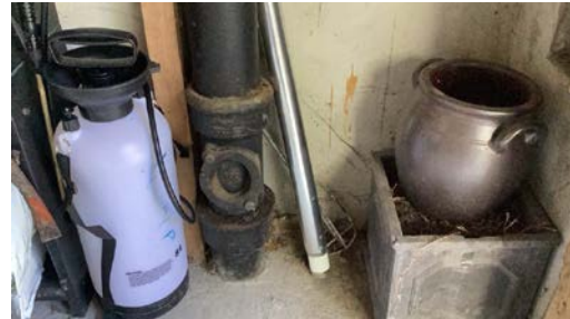
Stakeluke på avløpsrør i garasje.
