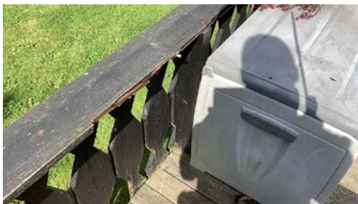
Råteskader i rekkverk.
