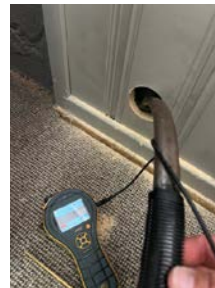
Måles fukt i utforet trevegg kjellerstue.
