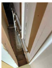
Kasse med vann og avløpsrør til bad
