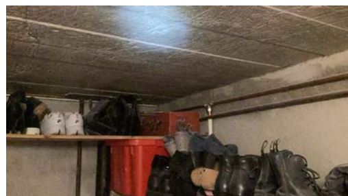
Synlige kopperrør i kjeller.
