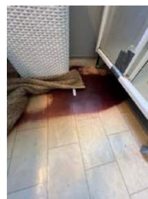
Misfarging i belegg på grunn av vanninntrengning mellom sluk og beleg, samt gulvvarme.
