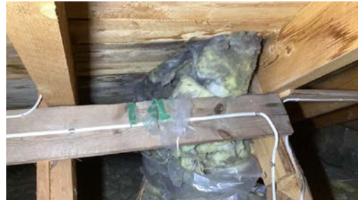
Tørre fuktskjolder ved lufteør.
