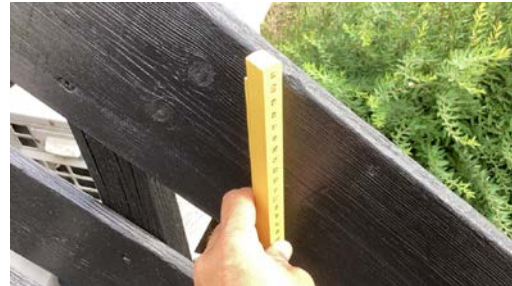
Rekkverk under 90cm.
