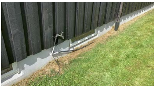
Gammel utekran med utvendig skjøterør til utekran foran huset.
