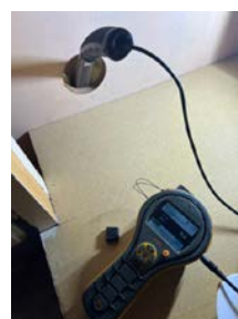
Måles ingen fukt i vegg mot dusjkabinett.
