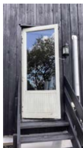
balkongdør med fuktskader, elde og slitasje.
