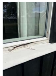
Råte i vindusramme ved spisestue.
