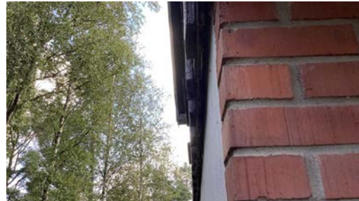
Ingen lufting bak kledning.
