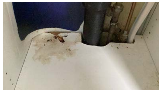
Fuktskjolder i servantskap.
