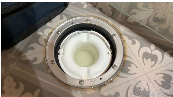
Kontroll av sluk. Enkelte riss i belegget i brett ned mot klemring.
