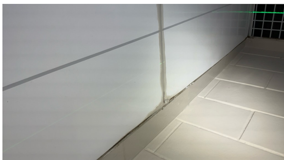
Fuktskader på baderomsplater i dusjsone.
