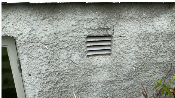
Sprekk i grunnmur registrert.
