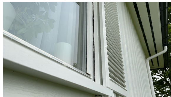
Glipper mellom vinduskarm og omramming. Dette øker risikoen for fukttinntregning.
