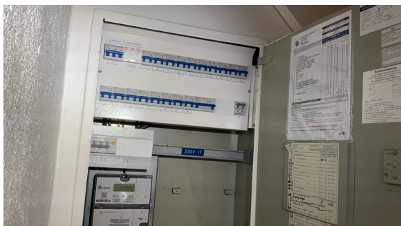
Sikringsskap i kjeller.
