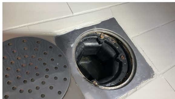
Kontroll av sluk, ikke synlig membran.
