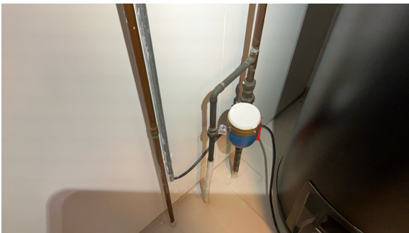
Stoppekran og vannmåler i bad kjeller.
