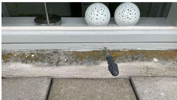
Råteskadd kjellervindu registrert. Forholdet gis tilstandsgrad 3.
