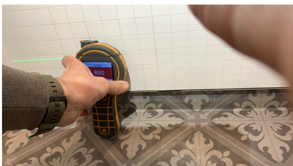
Fuktsøk på baderomspanel i dusjsone viste forhøyde verdier.
