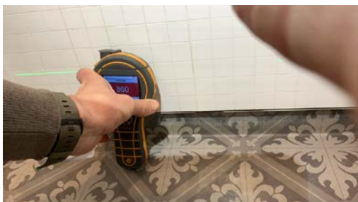
Fuktsøk på baderomslater i dusjsone viste forhøyde verdier.
