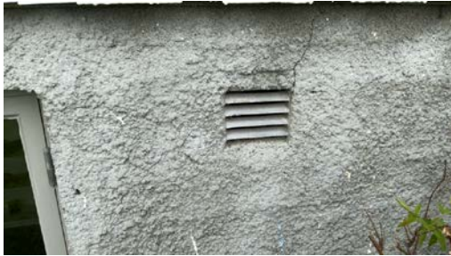
Sprekk i grunnmur registrert.
