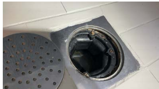
Kontroll av sluk, ikke synlig membran.
