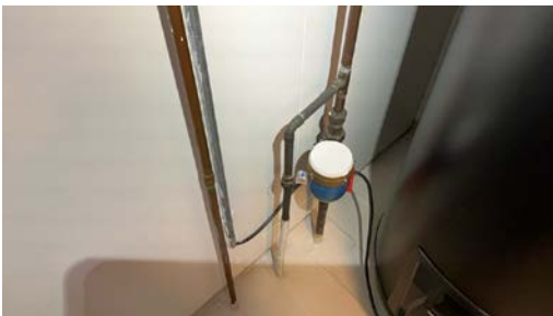
Stoppekran og vannmåler i bad kjeller.
