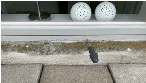
Råteskadd kjellervindu registrert. Forholdet gis tilstandsgrad 3.
