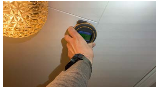
Fuktmerker/svelling i himling toalettrom kjeller. Fuktsøk viste normale verdier.
