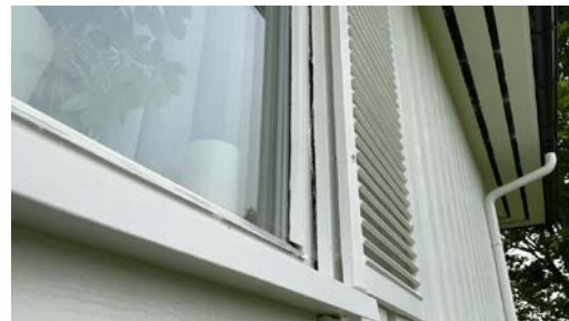
Glipper mellom vinduskarm og omramming. Dette øker risikoen for fuktinntregning.
