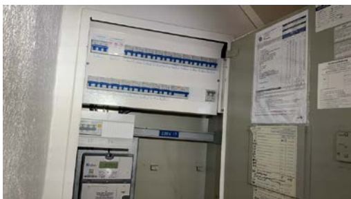
Sikringsskap i kjeller.
