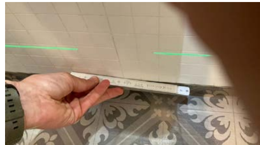
Svelling på baderomspanel
