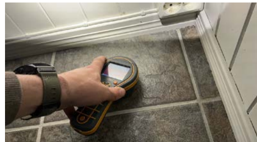
Enkle fuktsøk viste forhøyde verdier.
