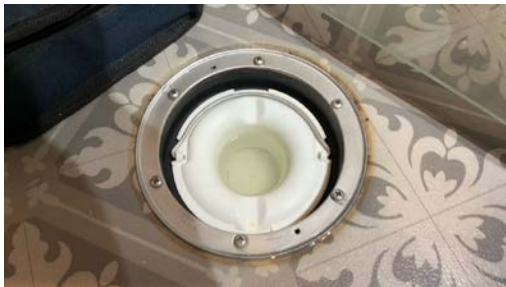
Kontroll av sluk. Enkelte riss i belegget i brett ned mot klemring.
