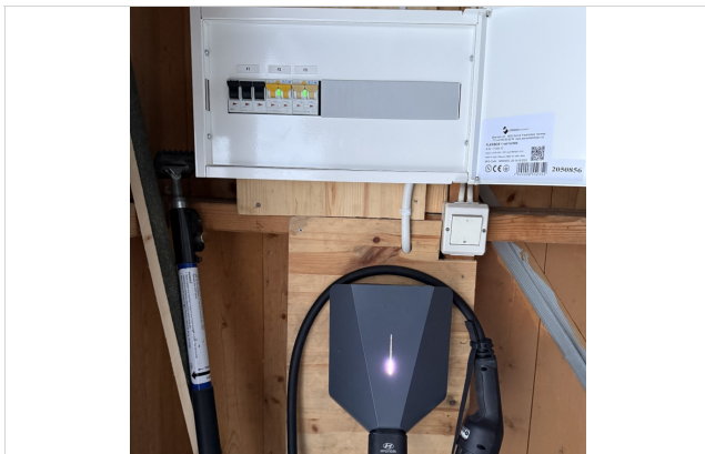
El-skap og lader i garasje
