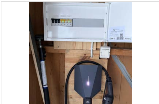
El-skap og lader i garasje
