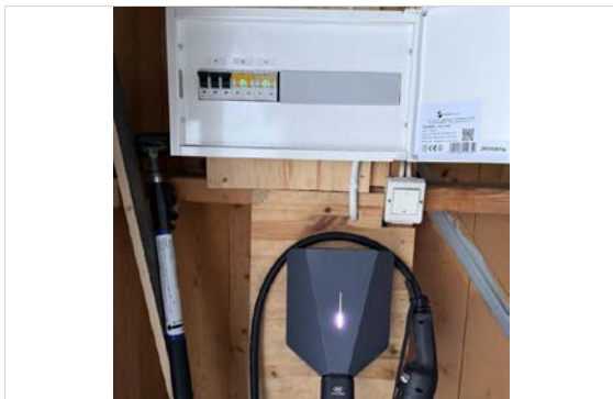
El-skap og lader i garasje
