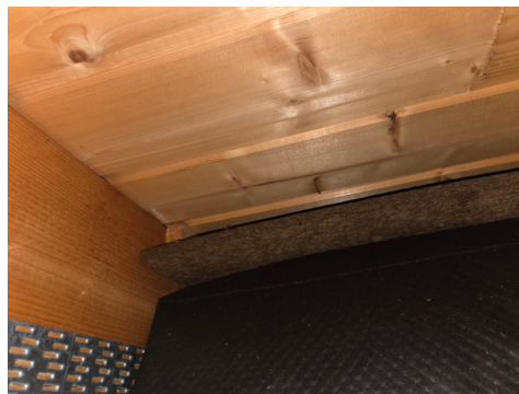
Luftespalte ved raft.
