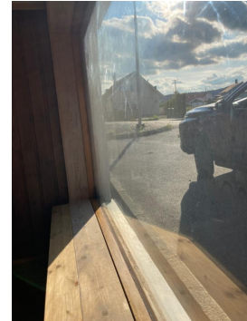
Butikkvindu har tegn som tyder på at er punktert.
