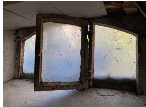
Eldre jernvindu i kjeller.
