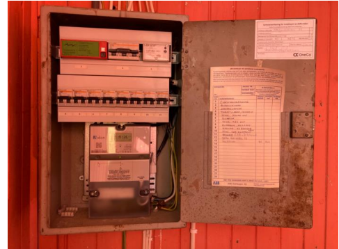
El-skap til næringslokale i trapperom kjeller.
