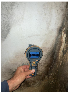
Fuktsøk viste fukt på kjellervegger.
