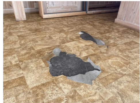
Skader på gulv i 1.etasje.
