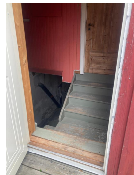
Trapp til 1.etasje mangler rekkverk.
