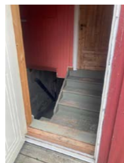
Trapp til 1.etasje mangler rekkverk.
