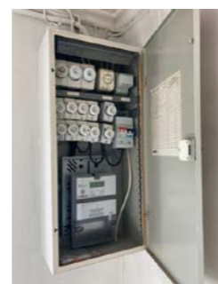
El-skap til boligdel i trapperom loftetasje.
