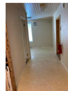
Rom med entre har skjevheter.
