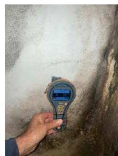
Fuktsøk viste fukt på kjellervegger.
