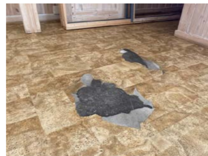
Skader på gulv i 1.etasje.
