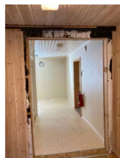
Flere overflater i 1.etasje er ikke ferdigstilt.
