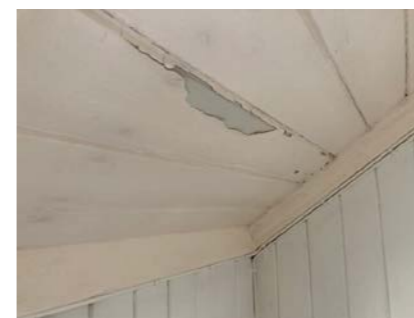
Overflater i loftetasje har til dels sterk slitasje.
