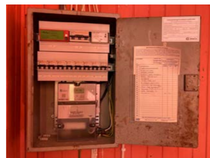
El-skap til næringslokale i trapperom kjeller.
