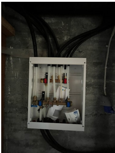
Manglende luke og merking av kurser
