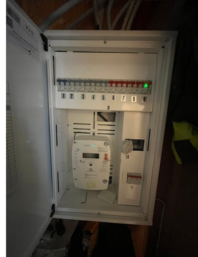
Sikringsskap i kjeller
