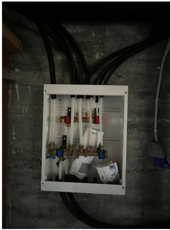
Manglende luke og merking av kurser
