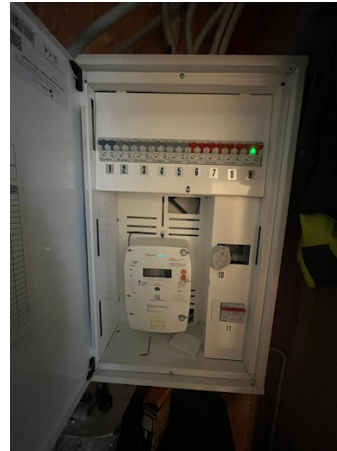
Sikringsskap i kjeller
