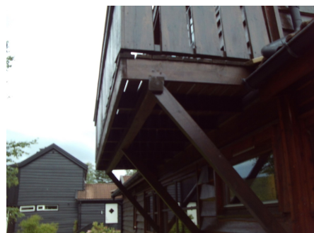
Har blitt noe mindre sig på veranda
