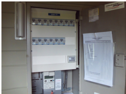
Sikringsskapet er plassert i gangen.
