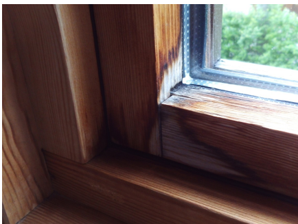
Noen kondensmerker på innvendig karm og ramme
