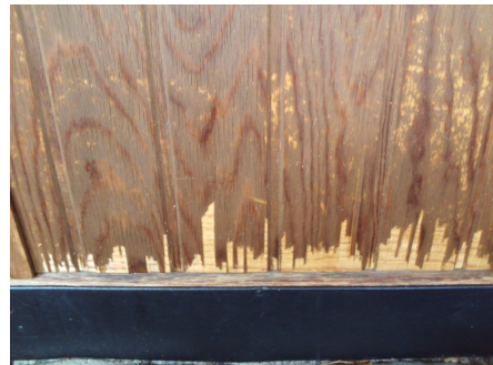
Tofløyet balkongdør har skader på utvendig brystning.
