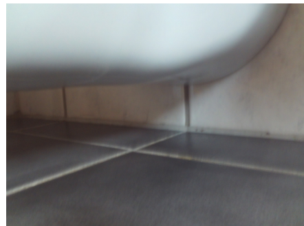
Ingen hull for synliggjøring av lekkasjevann
