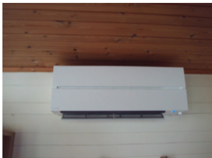
Varmepumpe i stue
