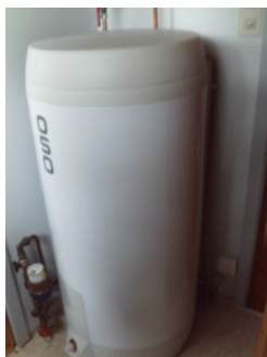
Ny bereder er plassert på vaskerommet
