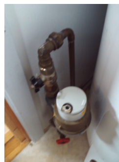
Stoppekran med vannmåler er plassert på vaskerommet
