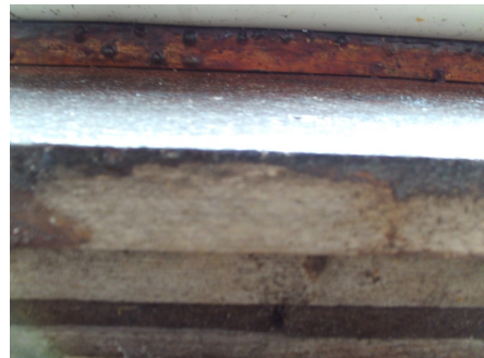
Ligger en lekte på tvers mot ringmur.
