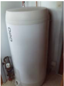
Ny bereder er plassert på vaskerommet
