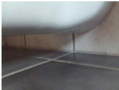
Ingen hull for synliggjøring av lekkasjevann
