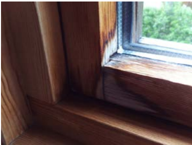
Noen kondensmerker på innvendig karm og ramme
