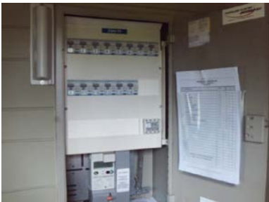
Sikringsskapet er plassert i gangen.
