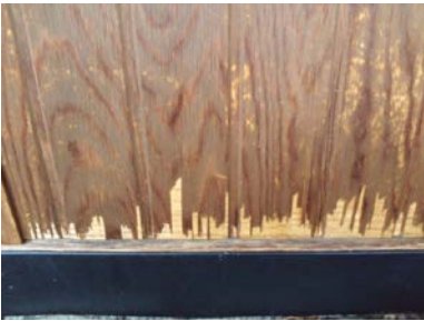
Tofløyet balkongdør har skader på utvendig brystning.
