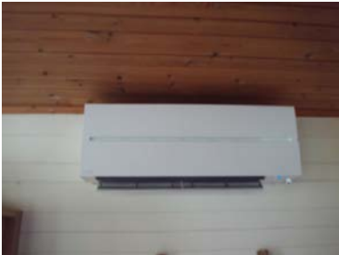
Varmepumpe i stue
