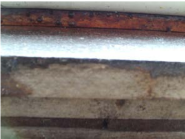
Ligger en lekte på tverrs mot ringmur.
