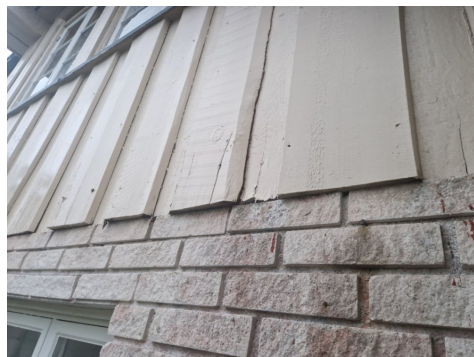
Synlig råteskader i fasadepanel.
