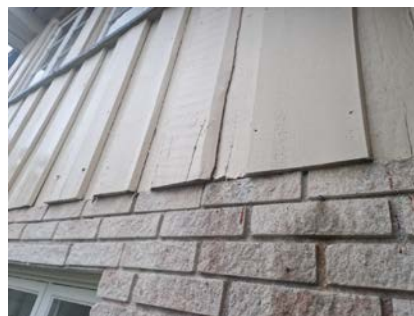
Synlig råteskader i fasadepanel.
