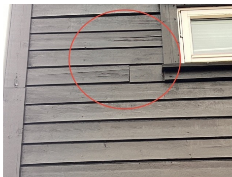
Råteskade i kledning
