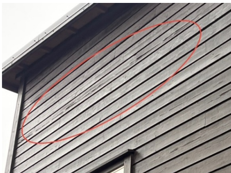
Råteskade i kledning
