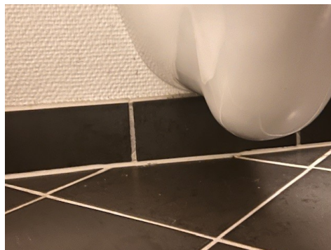
Ingen synlig lekkasje varsler under toalett
