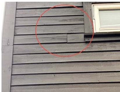
Råteskade i kledning
