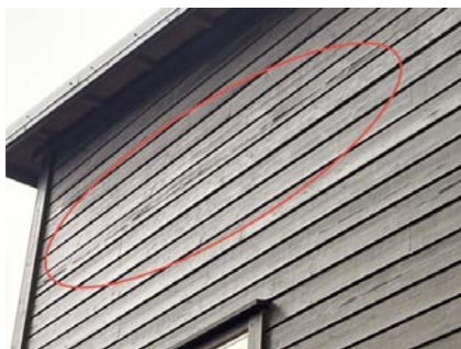
Råteskade i kledning
