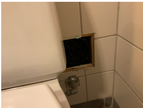
Mangelfull tetting av stakeluke i vegg i våtsone. Løkk skal være vanntett.
