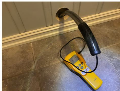
Fuktmåling er utført fra tilstøtende gang.
