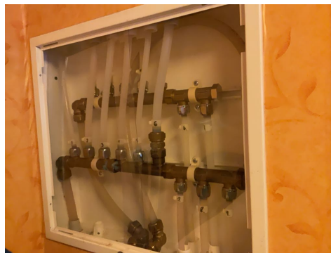
Rørskap montert på vaskerom
