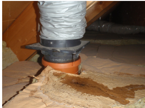
Isdannelse i skjøt på kanal. Det var fukt på isolasjon på befaringsdagen. Kanal må isoleres og tettes bed
