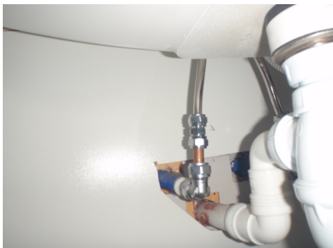
Manglende tetting rundt rørgjennomføring i vegg
