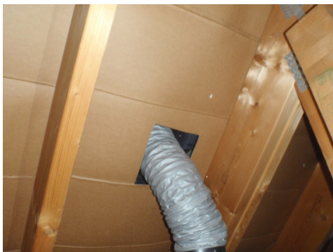
Mangelfull tetting av undertak rundt rørgjennomføringer.
