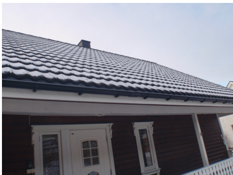
Det er ikke montert snøfangere
