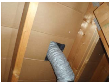
Mangelfull tetting av undertak rundt rørgjennomføringer.
