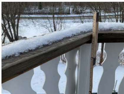
Høyde rekkverk er målt til 94 cm. Dagens krav til høyde på rekkverk er 100 cm.
