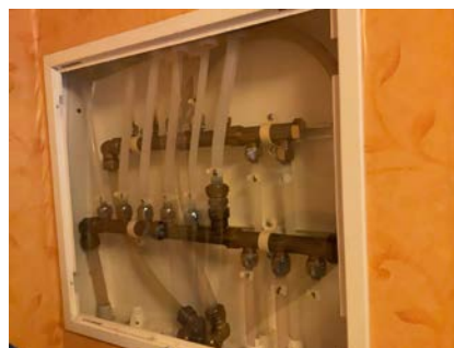
Rørskap montert på vaskerom
