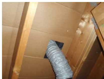
Mangler mansjett/tetting rundt rørgjennomføring i undertak. Fuktmerker på tro på nedsiden av åpning for gjennomføring
