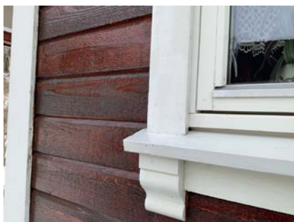
Det skal være åpning mellom omrammingsbord og beslag for å unngå fuktopptrekk og fukt/råteskader på omrammingsbord
