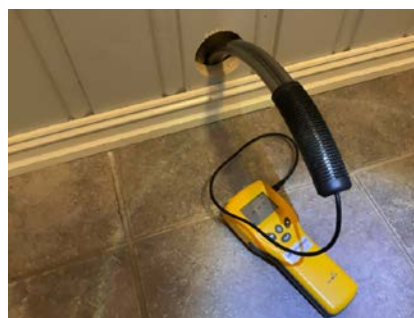
Fuktmåling er utført fra tilstøtende gang.
