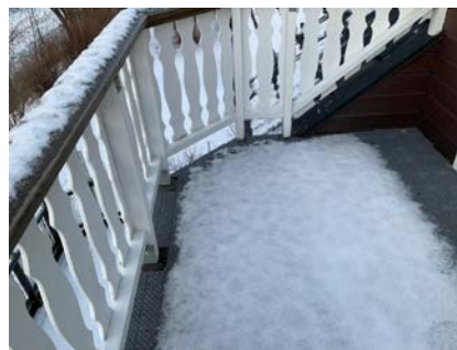
Det er over 10 cm. åpning mellom balkongdekke og rekkverk
