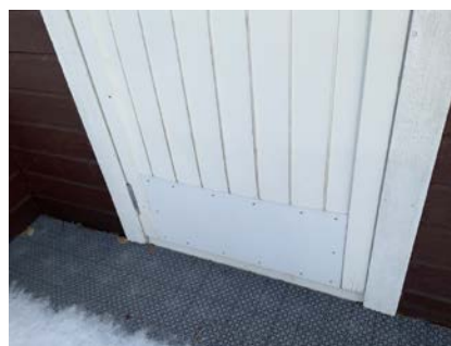
Balkongdør i 2. etg. Panelplate er fuktskadet og utsvelt
