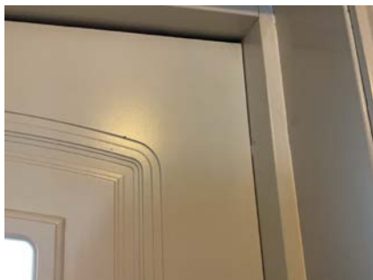
Dør "henger noe", må påregnes å justeres innen noe tid
