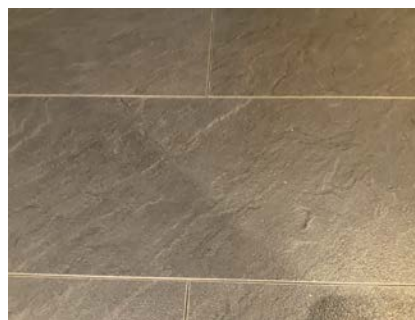
Skade på kjøkkengulv
