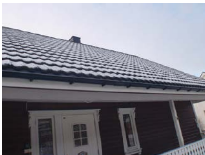
Det er ikke montert snøfangere
