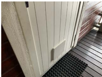
Innmontert katteluke i dør til vaskerom.
