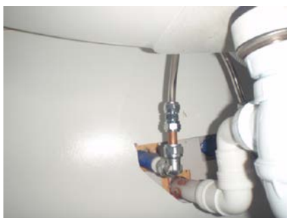
Manglende tetting rundt rørgjennomføring i vegg
