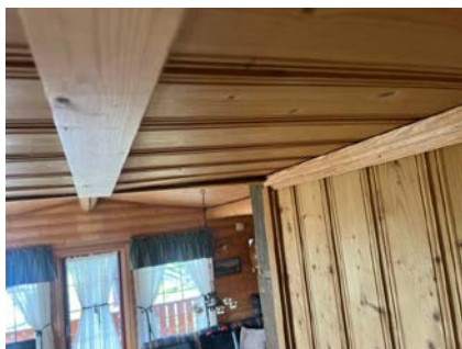
Skjevhet i overgang stue til kjøkken fra flatthimling til raustet himling
