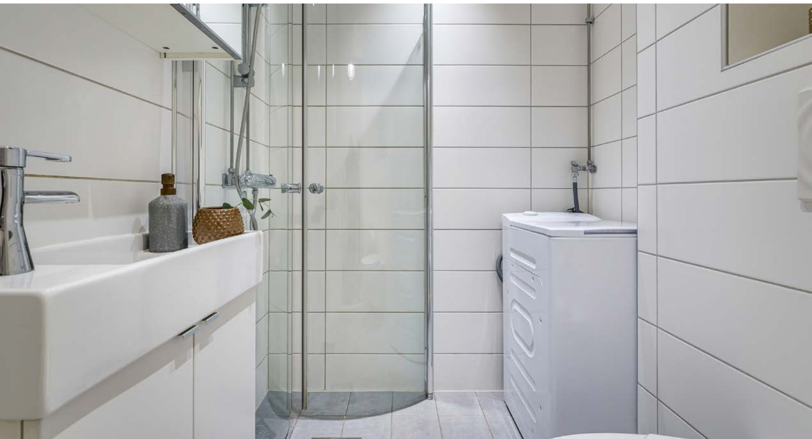
Rommet er utstyrt med vegghengt toalett, servantskap med ovenpåliggende servant, dusjhjørne og opplegg for vaskemaskin.
