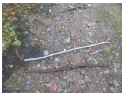
Jordkabel fra uthus til hytta ligger ubeskyttet på bakken.
