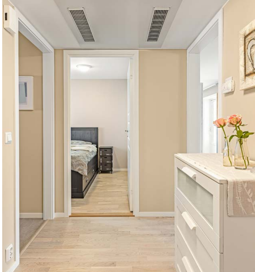
I taket er det viftekonvektor som sprer varme.
