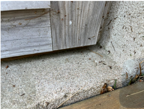
Manglende beslag/tetting under dør.
