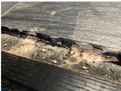
Skade/manglende oppbrett, membran, mot terskel.
