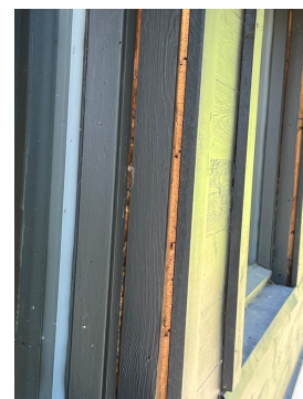
Glippe i omramming på vinduer
