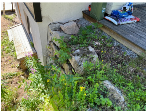
Manglende sikring på støttemur
