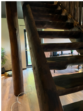
Manglende rekkverk en side av trapp.
