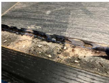
Skade/manglende oppbrett, membran, mot terskel.
