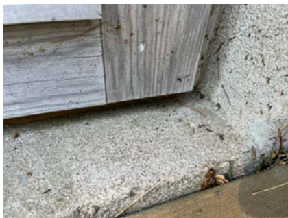
Manglende beslag/tetting under dør.
