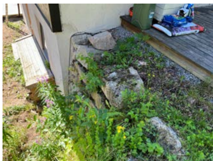
Manglende sikring på støttemur
