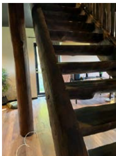
Manglende rekkverk en side av trapp.
