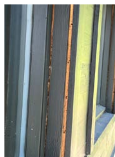
Glippe i omramming på vinduer
