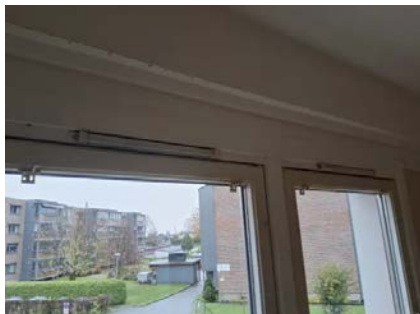
Leiligheten har naturlig ventilasjon med spalteventiler i vinduer.
