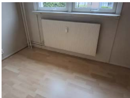
Leiligheten er oppvarmet med radiatorer.
