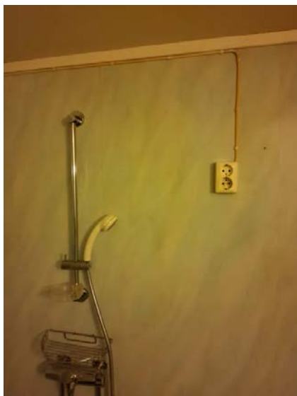
Stikkontakt er plassert i dusjsone.
