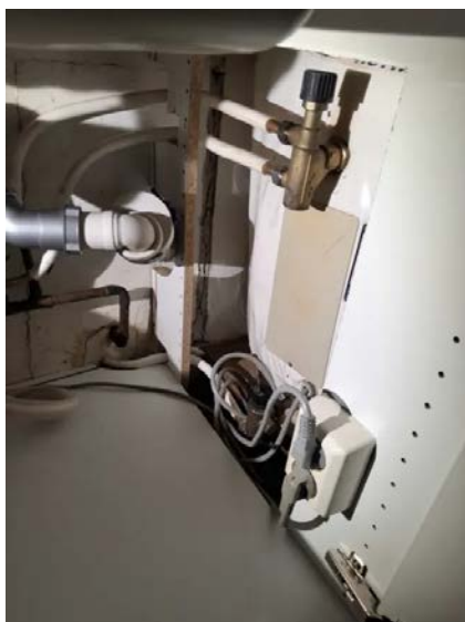
Varmtvannsbereder er plassert i kjøkkeninnredning.
