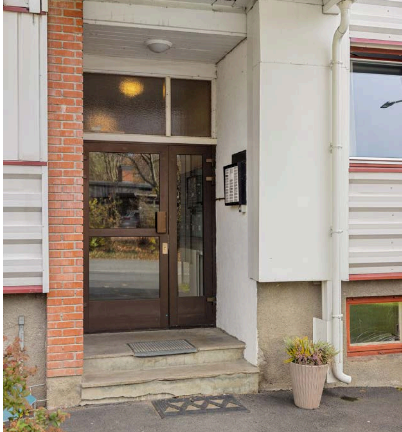
Overbygget inngangsparti med callinganlegg.
