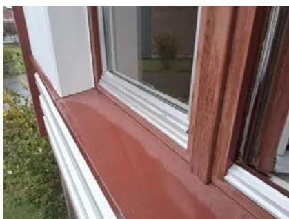
Vinduer er værslitt.
