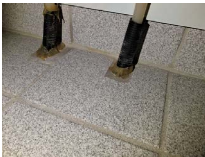
Det er ikke benyttet mansjetter rundt rørgjennomføringer i gulv.
