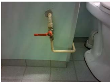
Hovedstoppekran er plassert på bad.
