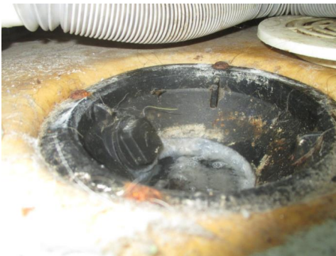
Sluk under dusjkabinett.
