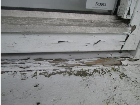
Større slitasje på utvendig karm og ramme.
