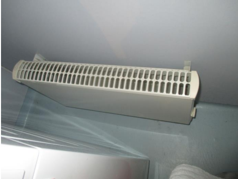
Panelovn på veggen.
