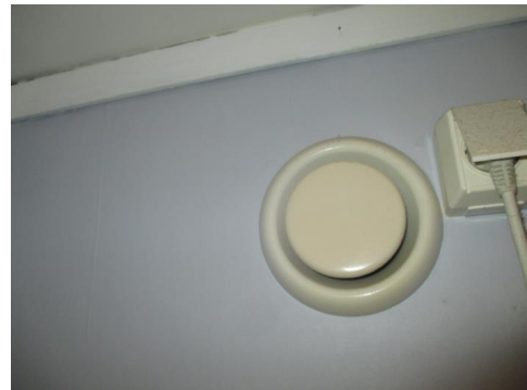
Ventil i ytterveggen.
