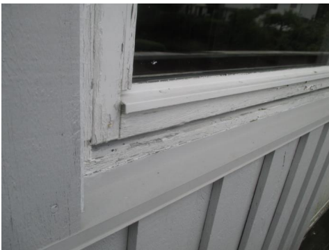
Utvendig vedlikehold må beregnes.
