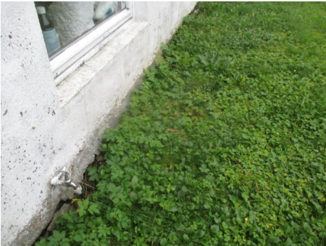
Noe fall inntil grunnmur på baksiden av boligen.
