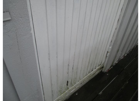
En del slitasje på utvendig brystning.
