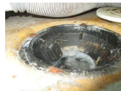
Sluk under dusjkabinett.
