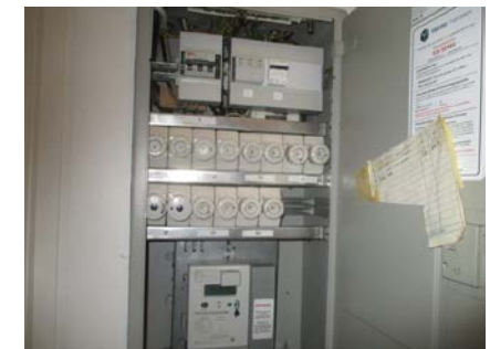
Sikringsskapet er plassert i vindfang.
