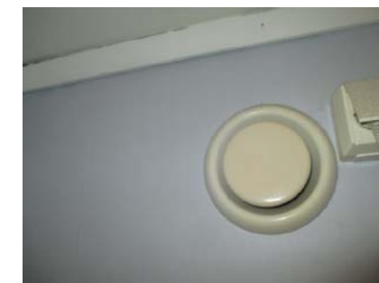
Ventil i ytterveggen.
