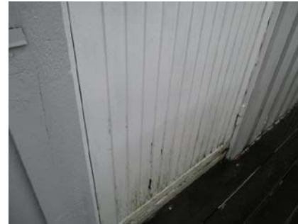
En del slitasje på utvendig brystning.
