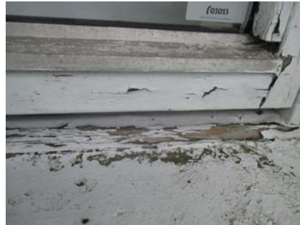
Større slitasje på utvendig karm og ramme.
