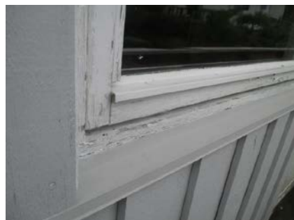
Utvendig vedlikehold må beregnes.
