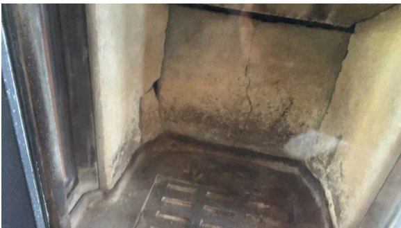
Sprekk i brannplater.
