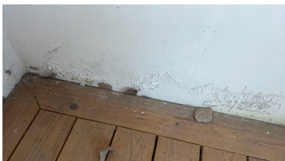
Saltutslag på mur ved kjellertrapp.
