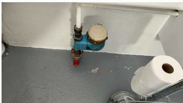
Vanninntak med stoppekran og vannmåler.
