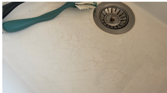
Krakeleringer i overflate på vask.
