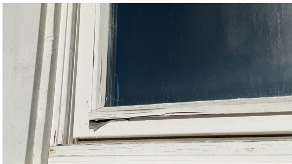
Eksempel på slitasje.
