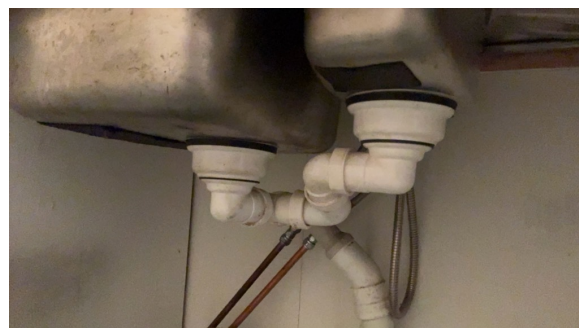
Usikkert om det har vært lekkasje fra avløp under vask.
