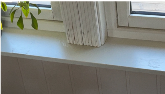
Slitasje på listverk.
