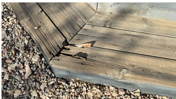
Råte på gulvbord ved entre.
