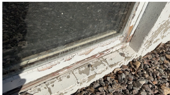
Eksempel på slitasje.
