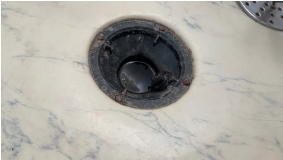
Sluk av plast med klemring.
