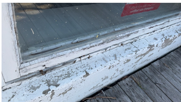
Eksempel på slitasje.
