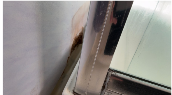
Fuktskade på veggplater bak dusj.
