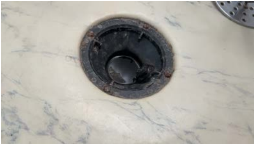
Sluk av plast med klemring.
