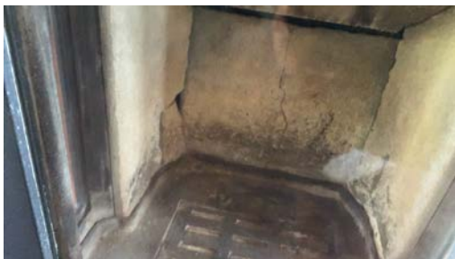
Sprekk i brannplater.
