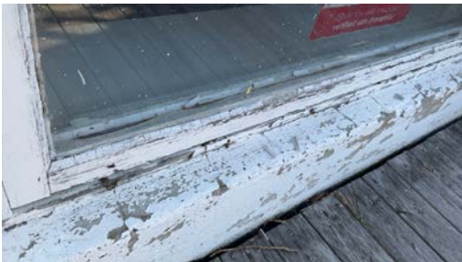
Eksempel på slitasje.
