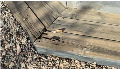
Råte på gulvbord ved entre.
