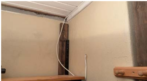
Løs kabel i kjeller.
