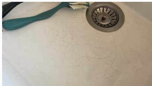
Krakeleringer i overflate på vask.
