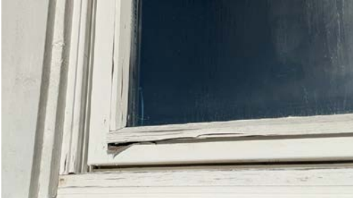
Eksempel på slitasje.
