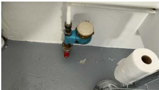
Vanninntak med stoppekran og vannmåler.
