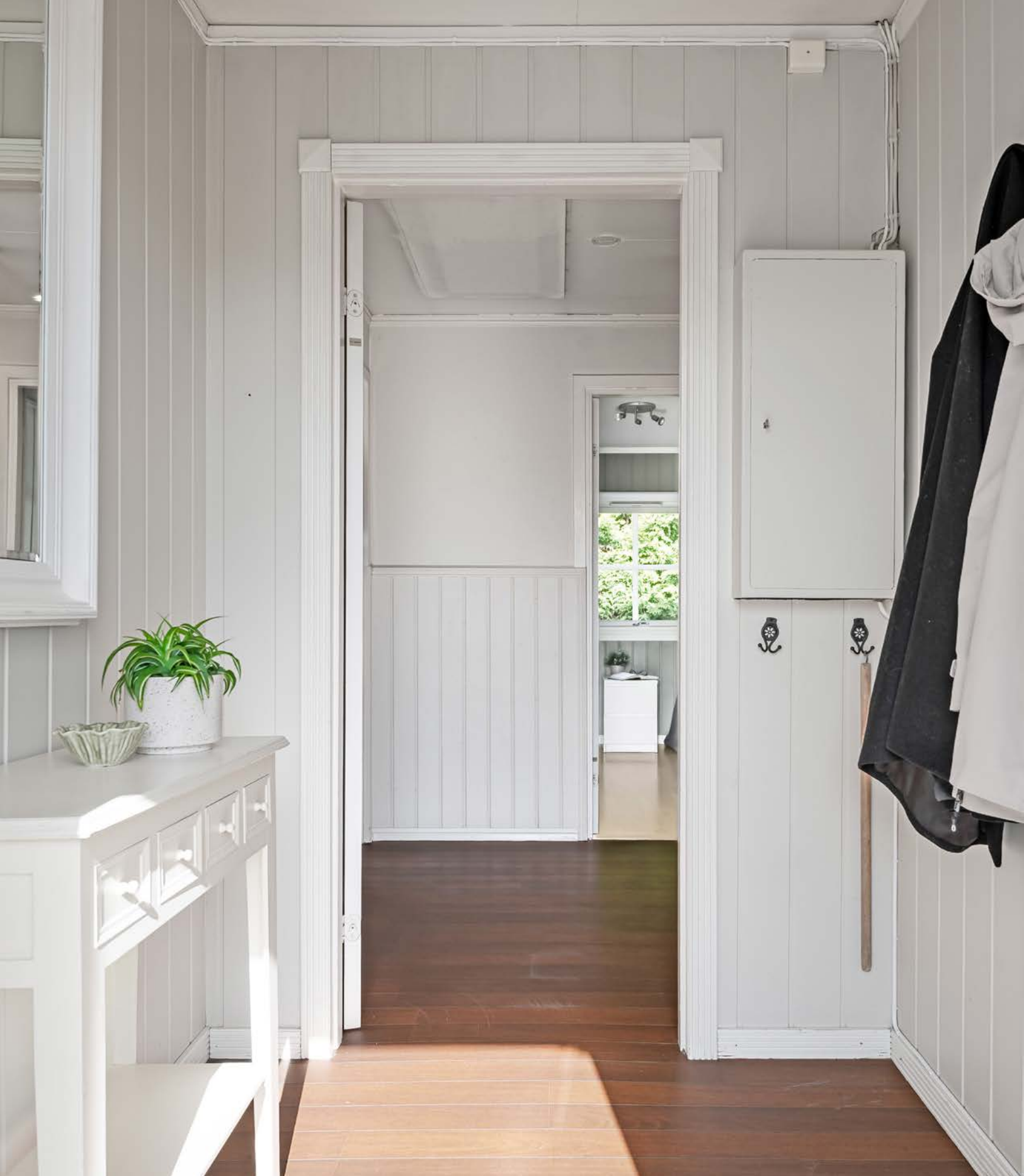
I entréen er sikringsskapet plassert.
