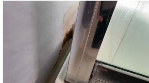
Fuktskade på veggplater bak dusj.
