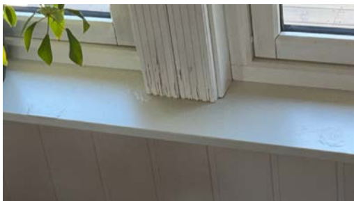
Slitasje på listverk.
