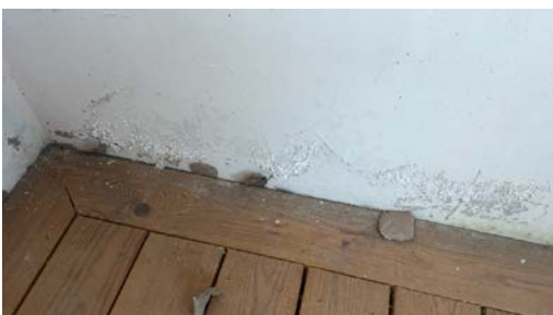
Saltutslag på mur ved kjellertrapp.
