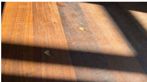
Stedvis slitasje på benkeplate.
