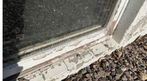
Eksempel på slitasje.
