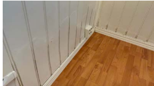
Fuktskade på vegg.
