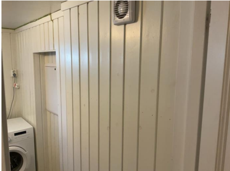
Brennbart materiale mot pipe på vaskerom.
