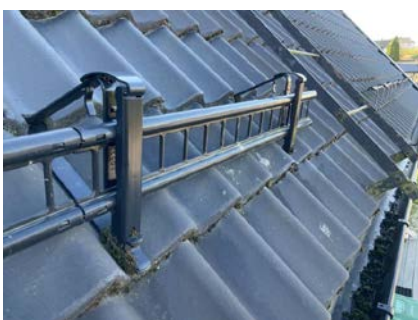
Feil lektaevstand på takstein på de 2 nederste taksteinene.
