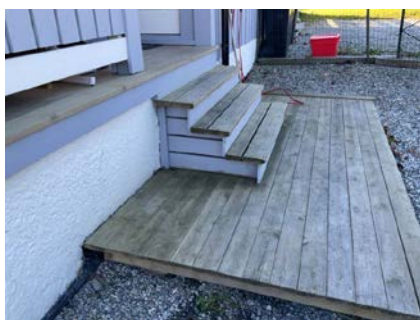
Trapp uten rekkverk til inngangsparti.
