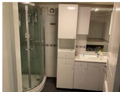
Bad med innredning og dusjkabinett.
