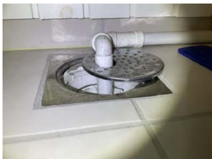
Sluk i gulv under innredning.
