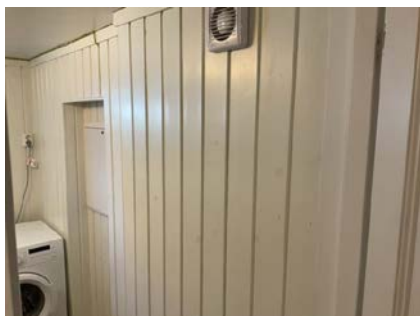
Brennbart materiale mot pipe på vaskerom.
